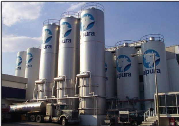
Tanques de Almacenamiento de Leche.
